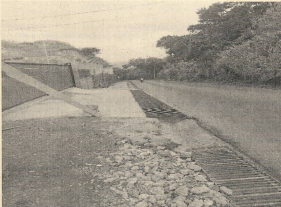
Figura 7. Obra en la vía que de Cali conduce al Saladito, para conducir aguas lluvias.
